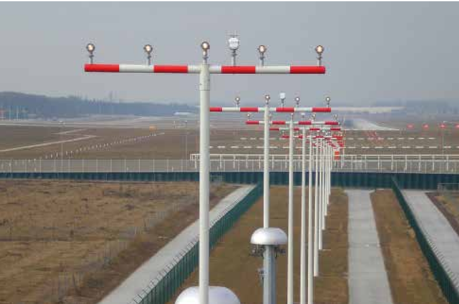
Sonderlösung – Mastaufbau mit NivaLift Absenksystem – Airport Frankfurt / Main
